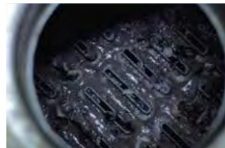
Protege el sistema de la acción corrosiva de los ácidos acumulados.
